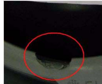
c) aus der Dichtung ausgerissenes Stück
